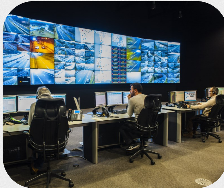
CENTRO COORDENAÇÃO OPERACIONAL BACKOFFICE DA OPERAÇÃO
